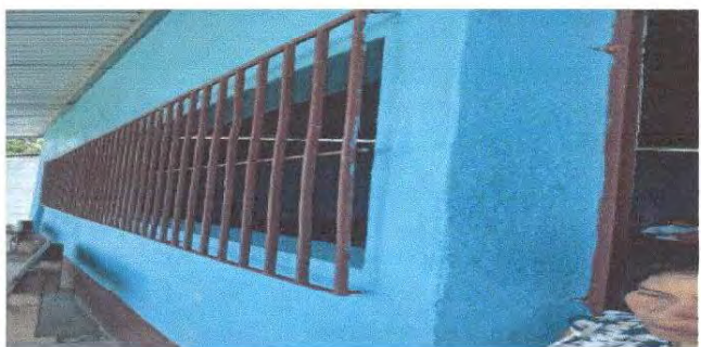
Foto 5: Sustrucción de ventana-balcon de metal aula 1.
